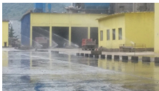
长阳公司现场雾化喷淋系统 On-site Spray system of Changyang plant
